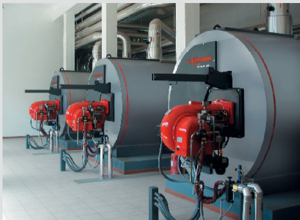
Водогрейный котел Vitomax 300-LT в эксплуатации.
