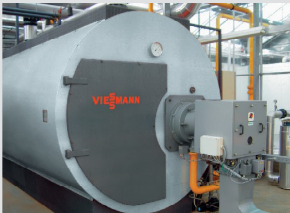
Водогрейный котел Vitomax 200-WS в эксплуатации.
